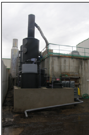
Figure 16 : Tour de lavage acide oxydo-basique
